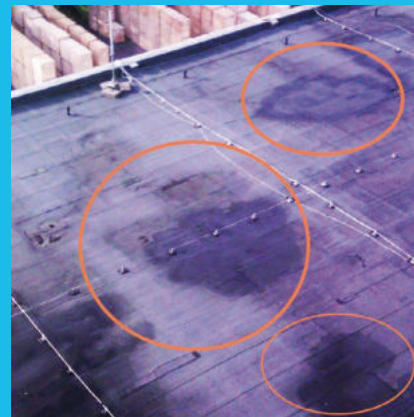
Poškodenie strechy zapríčinené nedostatočným vyspádaním strechy.
